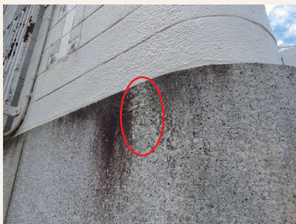
図2 空襲による被災の跡(赤枠部分) 焼夷弾の直撃による破損が確認されています。
