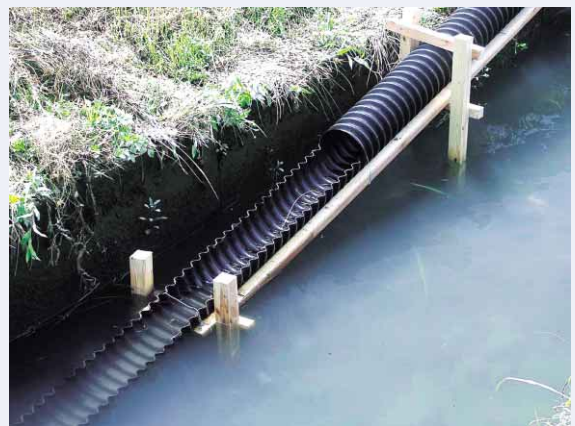
図3 蛇腹状の溝のある樹脂製魚道(コルゲート管魚道)
