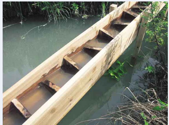
図2 斜めに切った仕切り板を配した木製魚道
